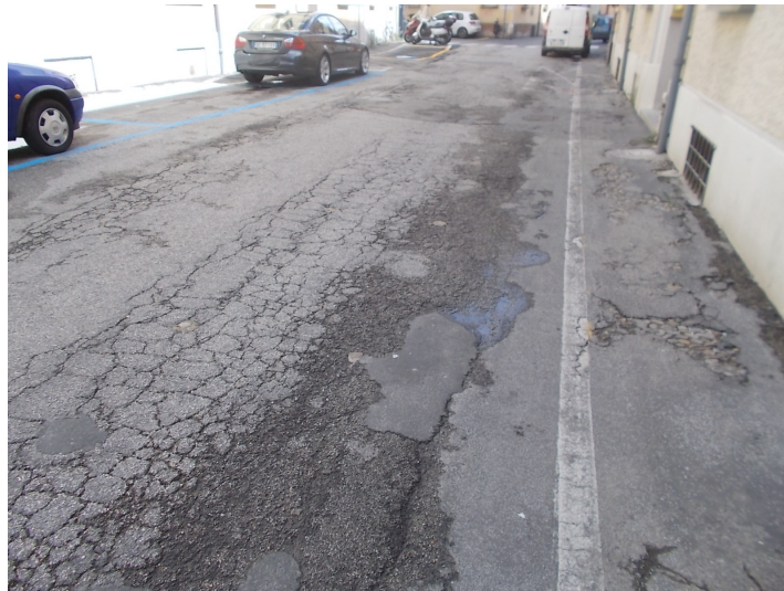
Via Bondiolo – particolare tratto degradato da bonificare
